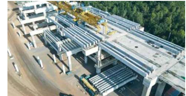
การก่อสร้างสถานีสระบุรี โครงการรถไฟความเร็วสูง สายกรุงเทพฯ - นครราชสีมา
