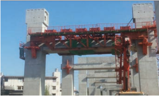
รูปที่ 1 งานติดตั้งเสาสำเร็จรูปของโครงสร้างทางวิ่งรถไฟยกระดับ
