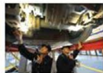
การบำรุงรักษาและซ่อมแซม EMU Maintenance & Repair
